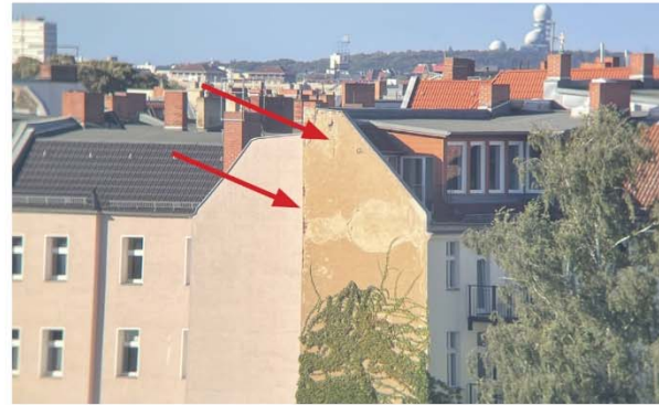
Abb. 15: Unverputzte Brandwand mit Nischen im offenen Mauerwerk
