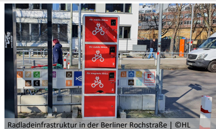
Radladeinfrastruktur in der Berliner Rochstraße | ©HL
