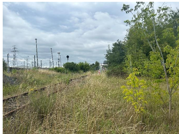
Abbildung 7: Gleisbereich in der Mitte der Beschattungsfläche
