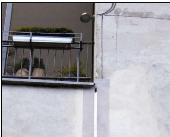
Abbildung 11: Spalte in der Brandwand
