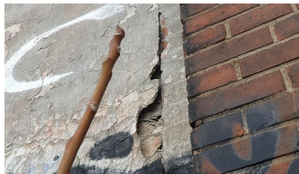
Abbildung 40: Quartierpotential hinter abbröckelnder Fassade
