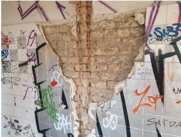
Abbildung 31: Hohlblicksteine hinter Fliesen
