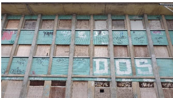
Abbildung 24: Mit Brettern verschlossene Fenster
