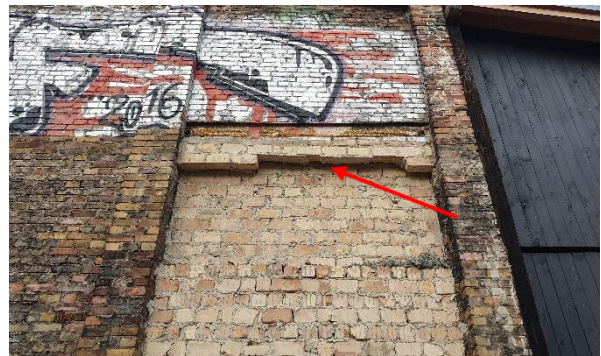
Abbildung 44: Spalte im Mauerwerk
