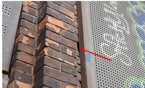
Abbildung 52: Einflugmöglichkeit zwischen Metallplatte und Mauerwerk
