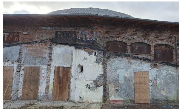
Abbildung 50: Verschlossene Fenster mit Holzbrettern
