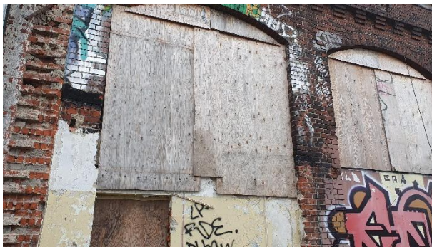
Abbildung 37: Mit Holzbrettern verschlossene Fenster
