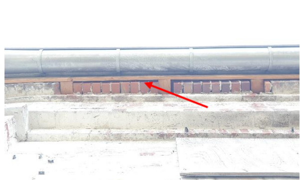
Abbildung 48: Spalten im Dachbereich zwischen Ziegelsteinen und Holzverstrebungen
