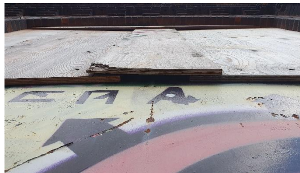
Abbildung 38: Spalt zwischen Holzbrettern, Einflugmöglichkeit
