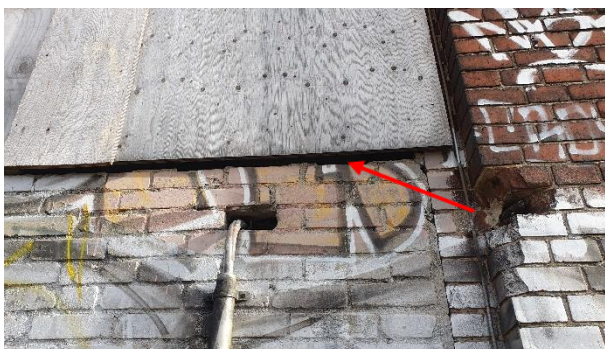
Abbildung 39: Spalt zwischen Mauerwerk und Holzbrett
