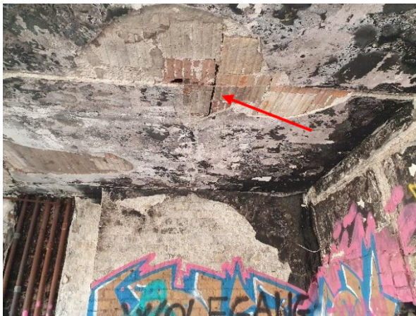
Abbildung 27: Spalt im Mauerwerk
