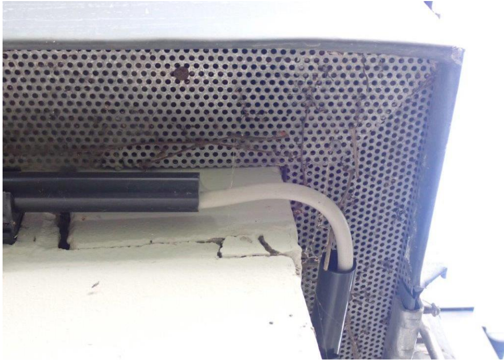
Abb. 7: Mit Lochblechen verschlossene Hohlräume unter den Attikablechen des UW-Gebäudes.
