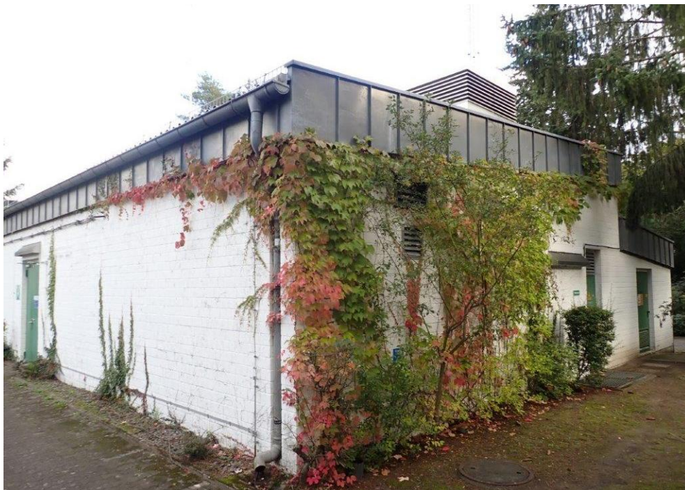
Abb. 8: Die westliche Ecke des UW-Gebäudes mit schütterem Fassadenbewuchs am 16.10.2023.
