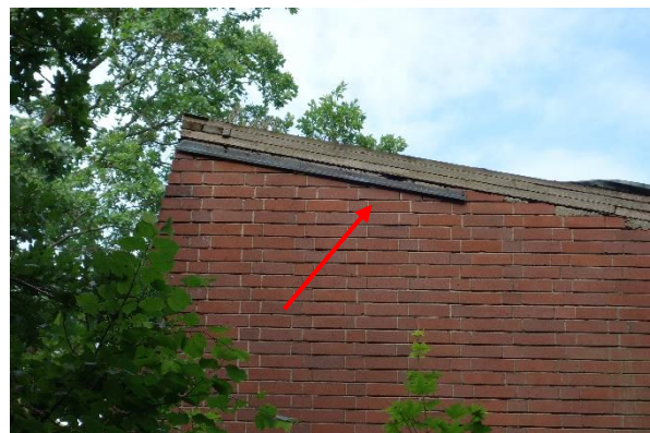
Abbildung 8: Spalten an der Dachkante
