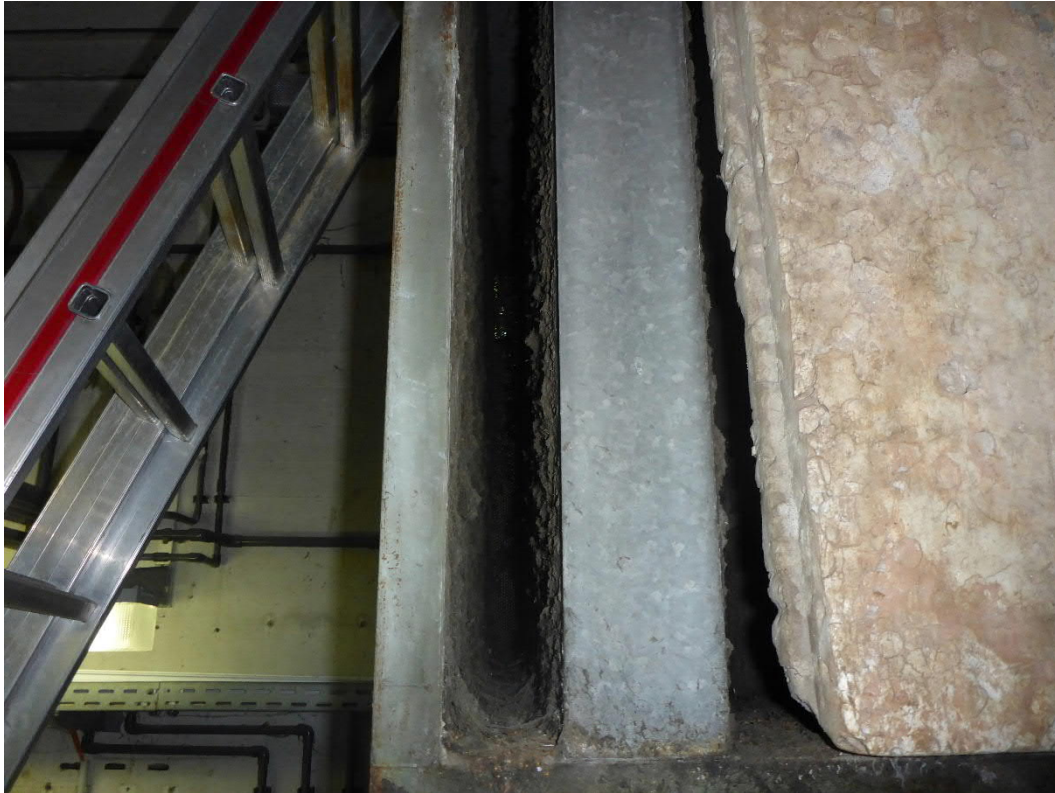
Abbildung 5: Spalten in Kellerräumen der Schwimmhalle
