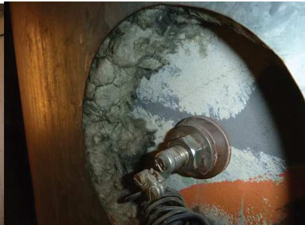
Abbildung 50: Detailaufnahme MiWo am Wasserbehälter KG
