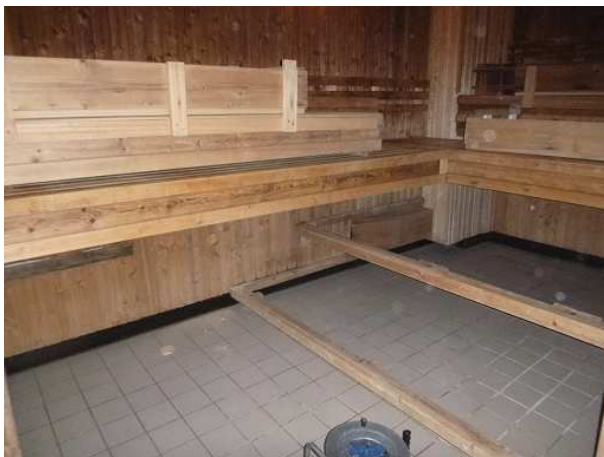
Abbildung 23: Ansicht Sauna Damen 1.OG
