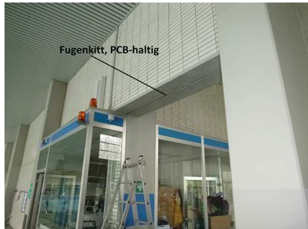
Abbildung 18: Fundstelle zu PCB-haltigen Fugenkitt in der Schwimmhalle
