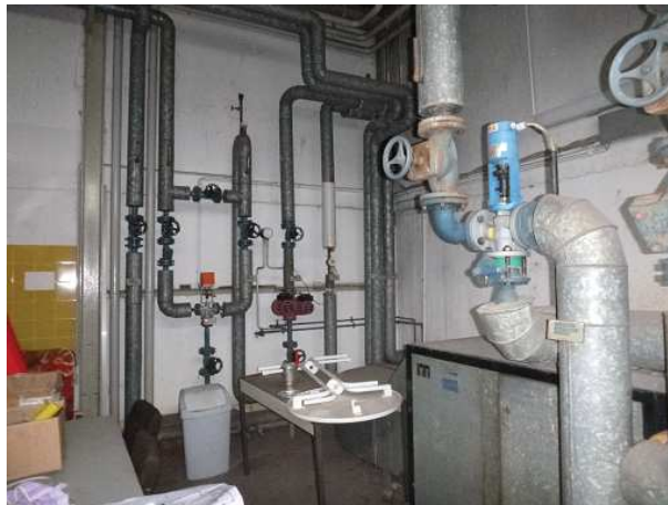
Abbildung 45: Beispiel asbesthaltige Flansche, Technikzentrale 1.OG
