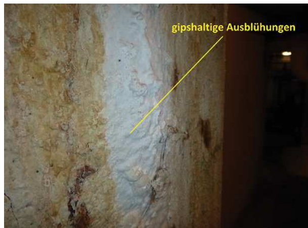
Abbildung 29: Ansichtsbsp. von Gipsausblühung im KG
