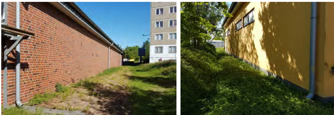
Abb./Tab. 5: Grünfläche/flache Mulde hinter dem Supermarkt (links) und dem Getränkemarkt (rechts). (eigene Aufnahmen).
