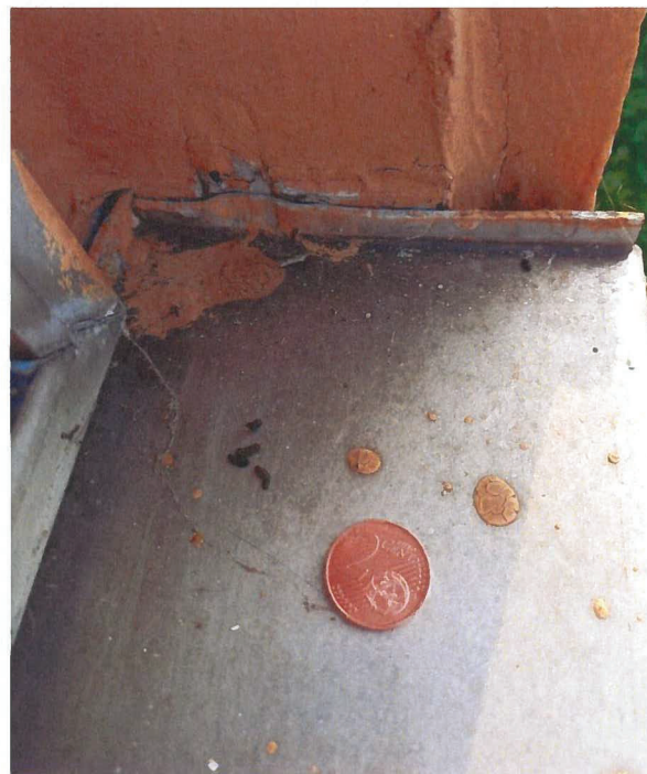
08.08.2022: Kotsuren unter Quartiersstruktur (Gebäude 2, Nordseite, 2. OG, 3. Raum von rechts)
