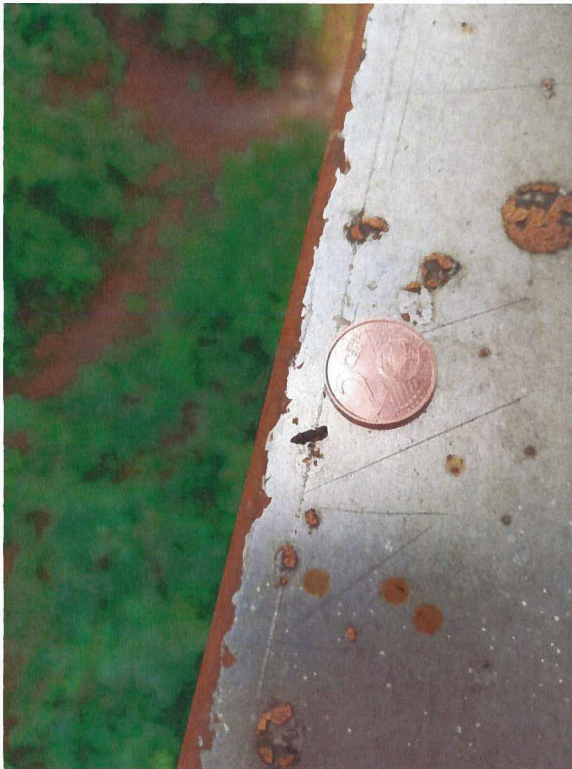
08.08.2022: Kotpuren unter Quartiersstruktur (Gebäude 3, Südseite, 2. OG, 2. Raum von links)
