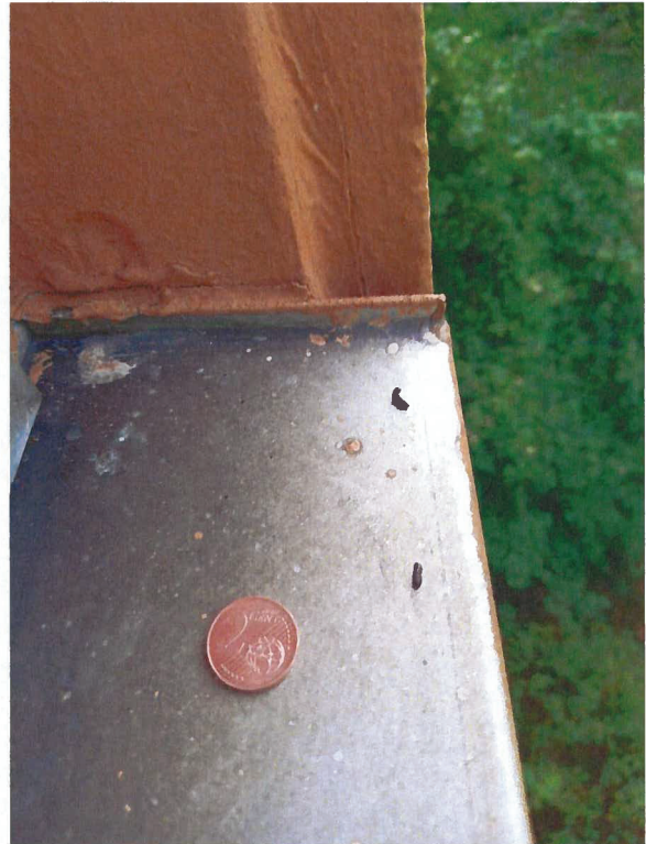
08.08.2022: Kotsuren unter Quartiersstruktur (Gebäude 2, Nordseite, 2. OG, 6. Raum von rechts)
