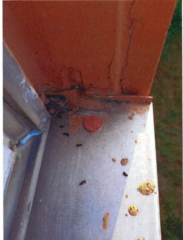
08.08.2022: Kotsuren unter Quartiersstruktur (Gebäude 2, Nordseite, 2. OG, 1. Raum von rechts)
