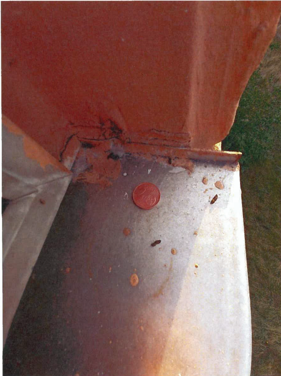
08.08.2022: Kotsuren unter Quartiersstruktur (Gebäude 2, Nordseite, 2. OG, 2. Raum von rechts)
