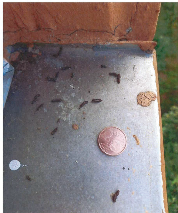
08.08.2022: Kotspuren unter Quartiersstruktur (Gebäude 1, Nordseite, 2. OG, 1. Raum von rechts)
