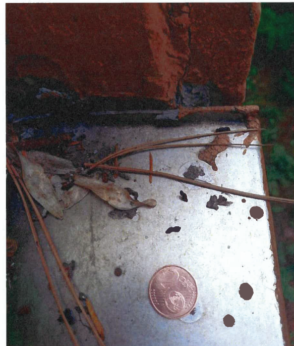
08.08.2022: Kotspuren unter Quartiersstruktur (Gebäude 1, Südseite, 1. OG, 4. Raum von rechts)
