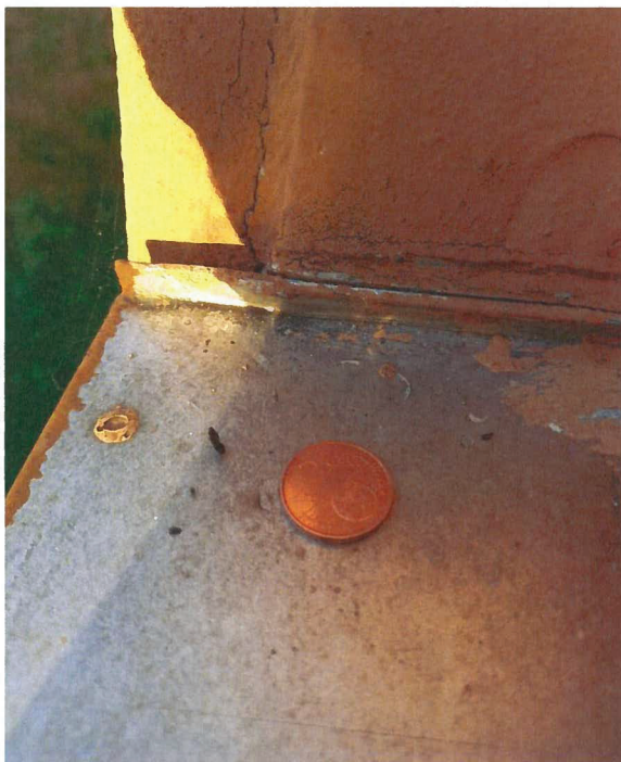
08.08.2022: Kotspur unter Quartiersstruktur (Gebäude 2, Nordseite, 2. OG, 5. Raum von rechts)
