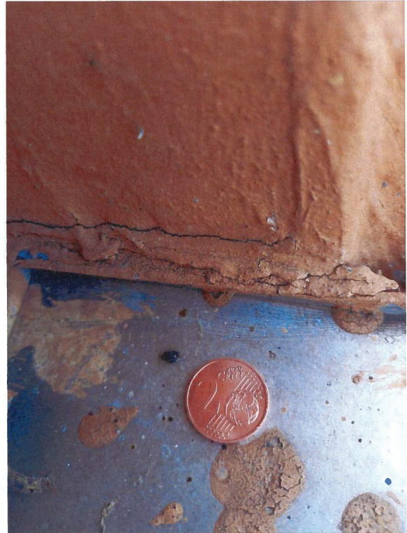
08.08.2022: Kotspur unter Quartiersstruktur (Gebäude 1, Nordseite, 2. OG, 4. Raum von rechts)
