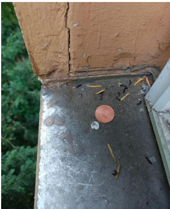
08.08.2022: Kotspuren unter Quartiersstruktur (Gebäude 1, Südseite, 2. OG, 2. Raum von rechts)
