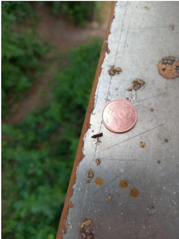
08.08.2022: Kotspuren unter Quartiersstruktur (Gebäude 3, Südseite, 2. OG, 2. Raum von links)
