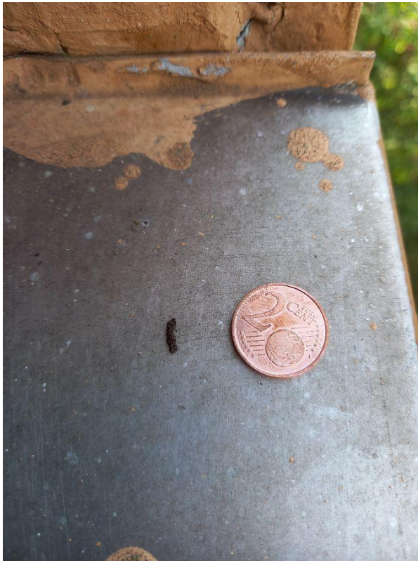
08.08.2022: Kotspur unter Quartiersstruktur (Gebäude 1, Nordseite, 2. OG, 3. Raum von rechts)
