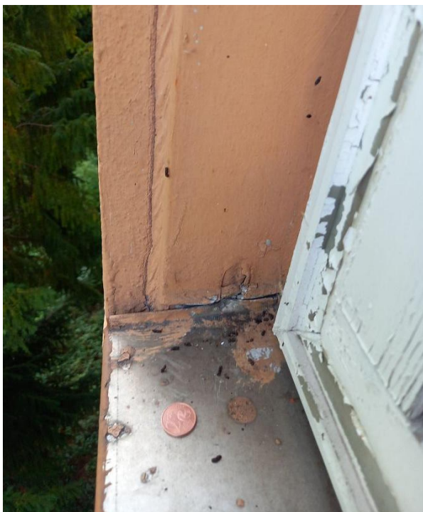
08.08.2022: Kotspuren unter Quartiersstruktur (Gebäude 2, Südseite, 2. OG, 1. Raum von links)
