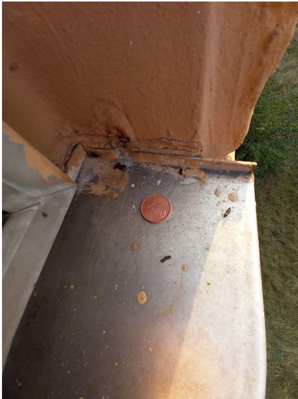
08.08.2022: Kotspuren unter Quartiersstruktur (Gebäude 2, Nordseite, 2. OG, 2. Raum von rechts)
