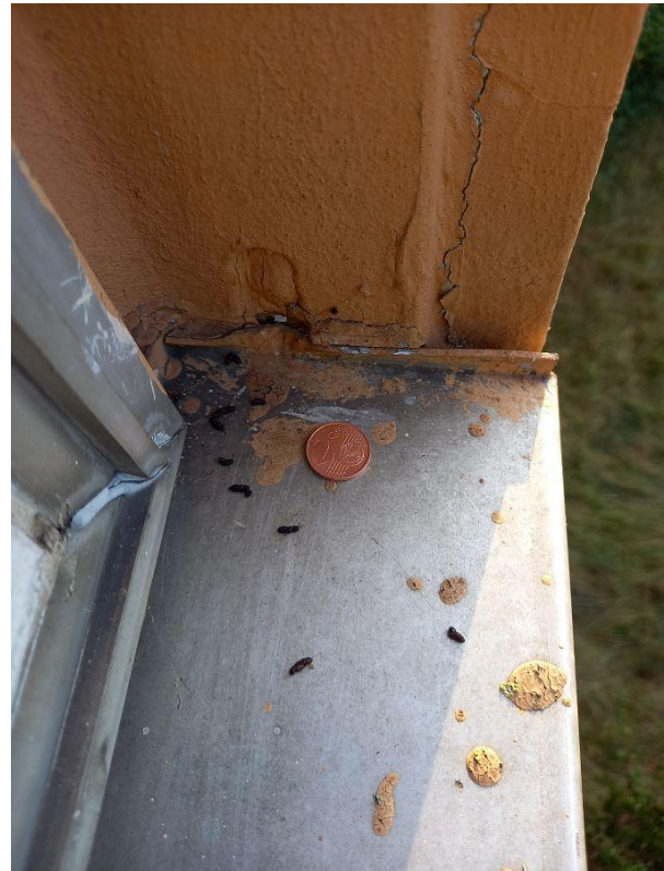
08.08.2022: Kotspuren unter Quartiersstruktur (Gebäude 2, Nordseite, 2. OG, 1. Raum von rechts)
