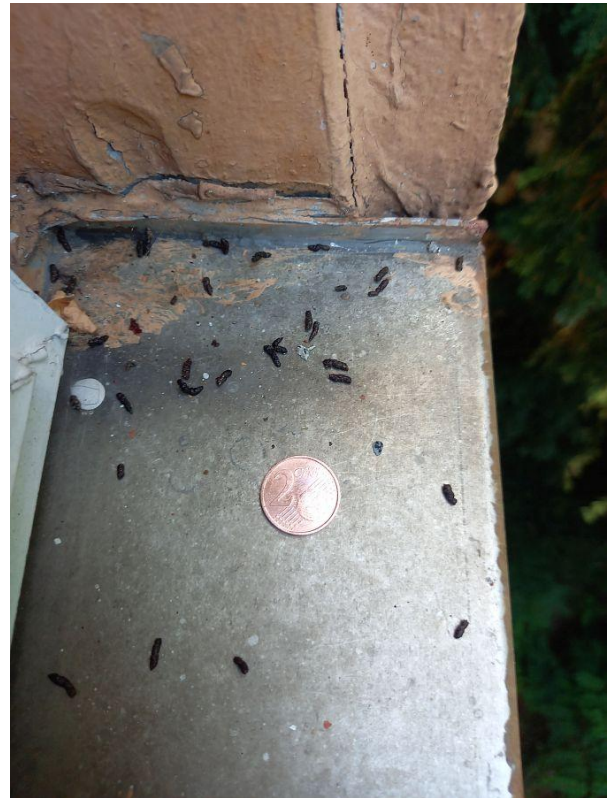
08.08.2022: Kotspuren unter Quartiersstruktur (Gebäude 1, Südseite, 2. OG, 3. Raum von rechts)
