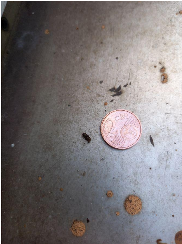
08.08.2022: Kotspur unter Quartiersstruktur (Gebäude 2, Südseite, 1. OG, 2. Raum von links)
