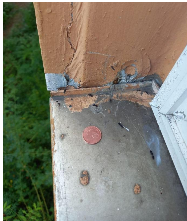
08.08.2022: Kotspuren unter Quartiersstruktur (Gebäude 3, Südseite, 2. OG, 4. Raum von links)
