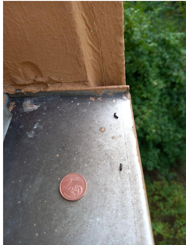
08.08.2022: Kotspuren unter Quartiersstruktur (Gebäude 2, Nordseite, 2. OG, 6. Raum von rechts)
