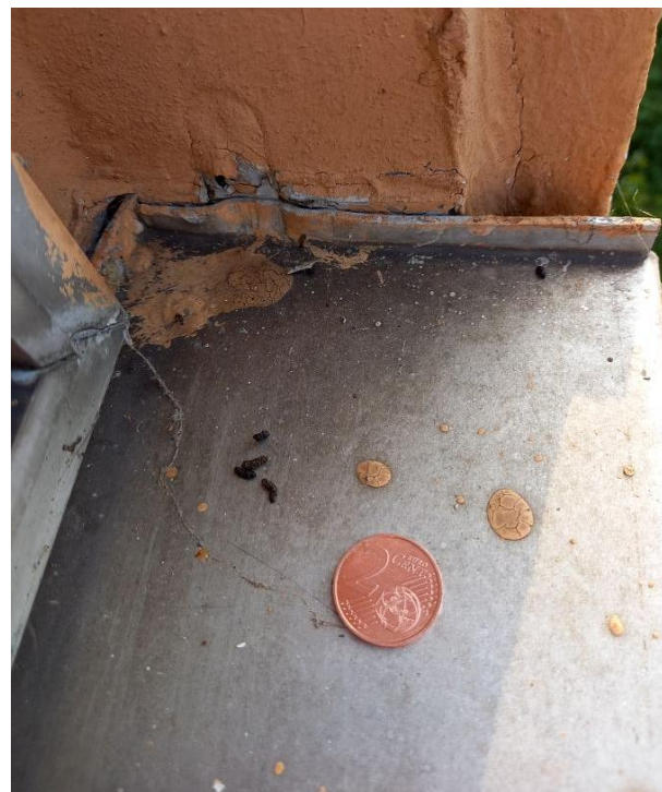
08.08.2022: Kotspuren unter Quartiersstruktur (Gebäude 2, Nordseite, 2. OG, 3. Raum von rechts)
