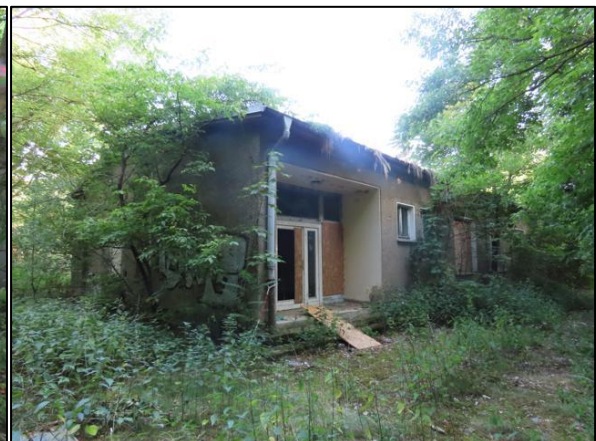
Abb. 20: Ruinöse Gebäude im westlichen Bereich des B-Plangebietes
