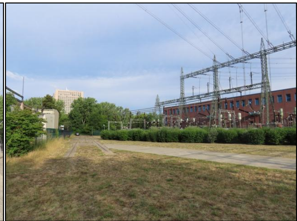
Abb. 18: Umspannwerk der 50 Hertz Transmission GmbH im Nordosten des B-Plangebietes
